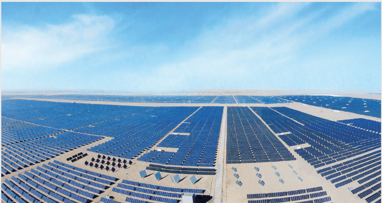
“互联网+光伏”智能光伏电站
