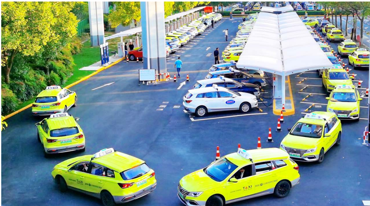
中国上海虹桥机场出租车充电场站
