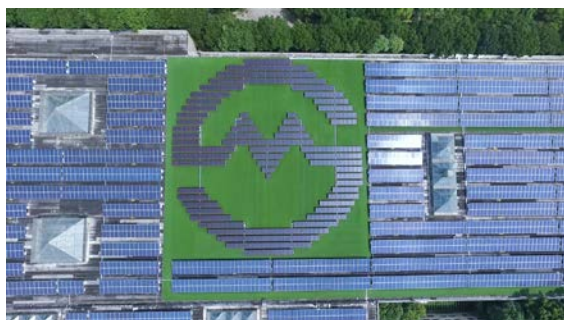
中国上海地铁龙阳路基地光伏电站，M字样光伏板代表地铁（Metro），绿色草坪象征环保
