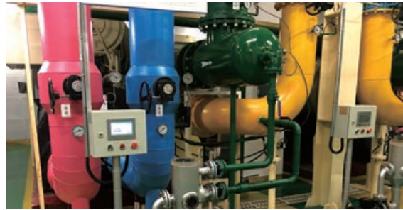
空调冷凝器在线清洗装置
