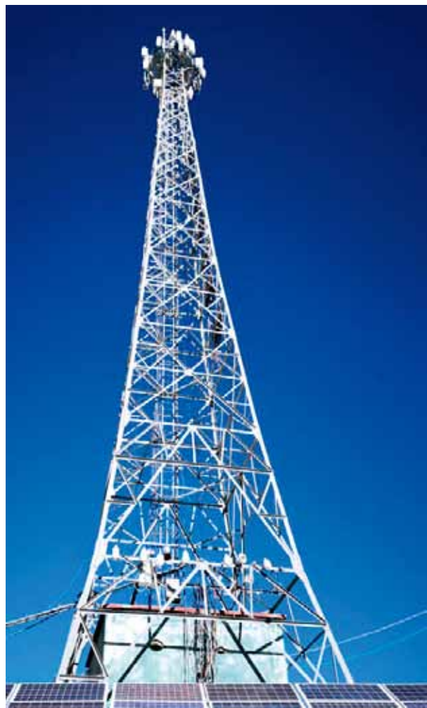
铁塔屹立不倒，电波永不消逝
