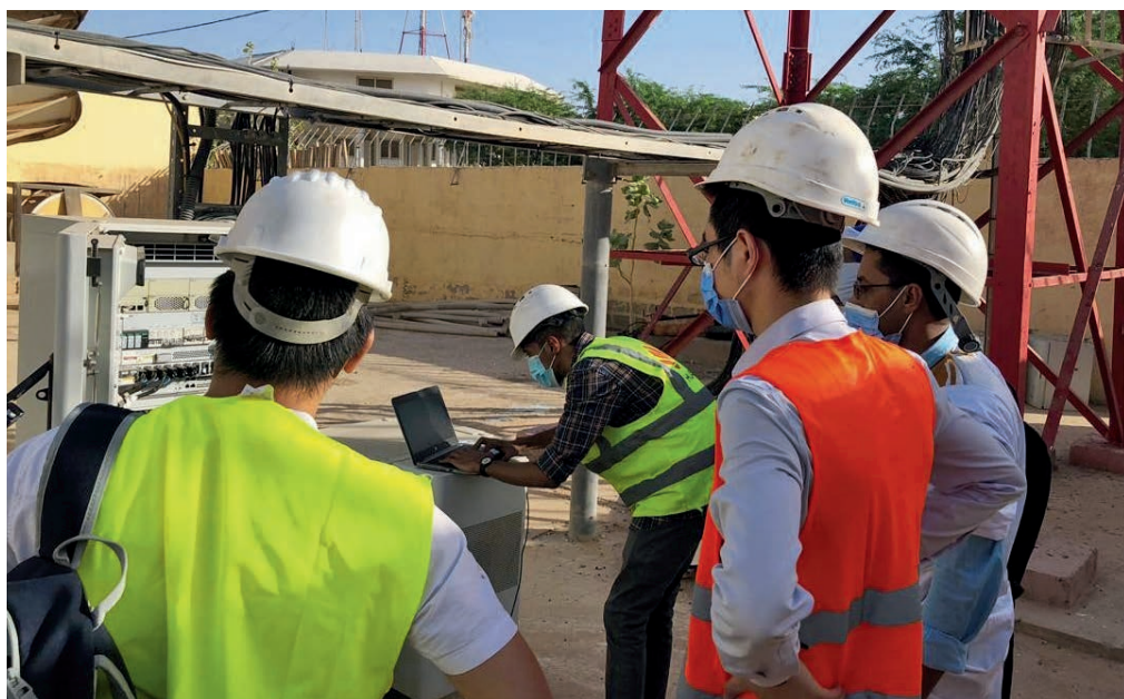
4G Pilot 站点开通现场
